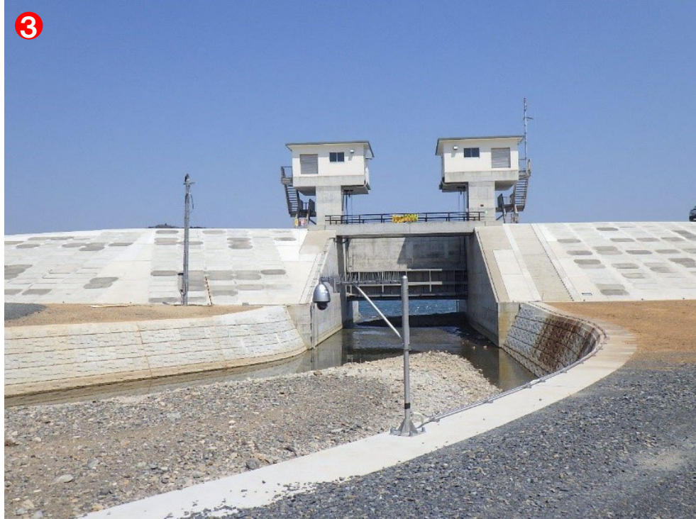
既設の水門に遠隔設備を付加した水門・陸閘自動閉鎖システム（谷川防潮水門）
